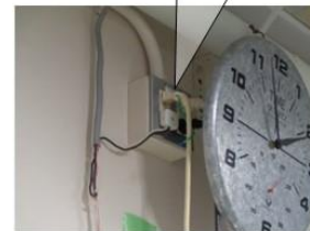
×コンセントの抜けかけ状態
