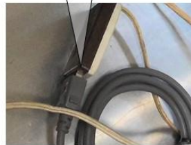
×コンセントの半差し状態
