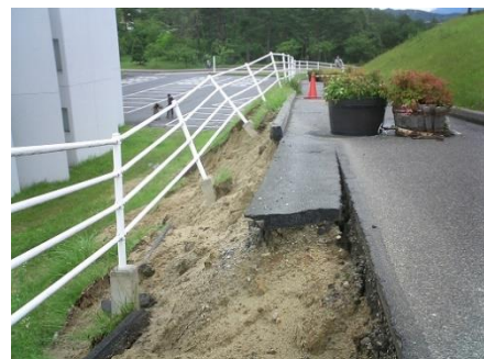
(大学構内の法面が一部崩壊)
