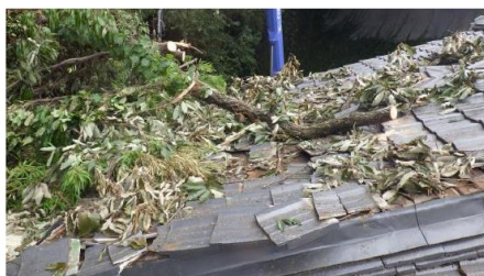
(管理する樹木が隣家の屋根に落下)
